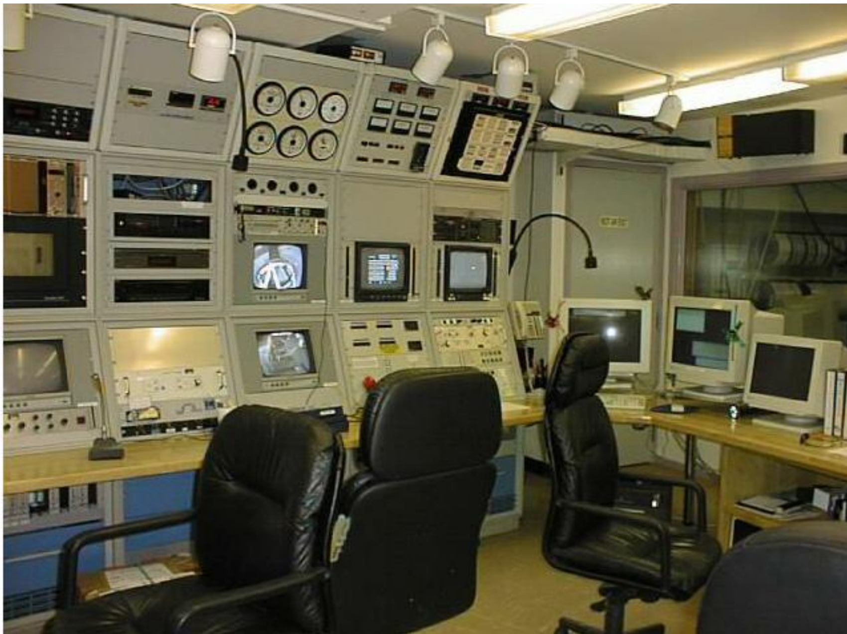
Salle de contrôle
